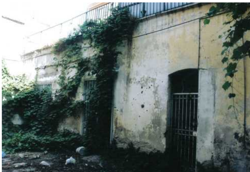
Veduta del lato interno col piano terrazzato (si notino le trasformazioni arbitrarie dei due vani d'accesso agli ambienti del piano terra, ove sono stati chiusi gli archi con piattabande e la chiusura di un tratto di accesso alla seconda scala)
